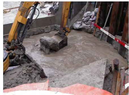
写真-9 : 液状化した地盤の状況
