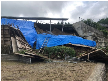
写真-2 崩壊後の様子
