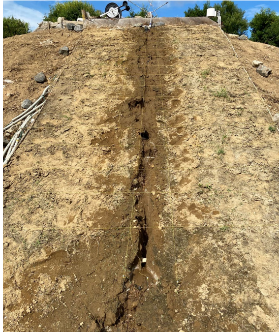
(a)放流後の侵食法面状況
