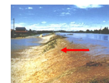
那珂川の越水: 出典)建設省常陸工事事務所資料
