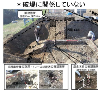
重信川の陥没箇所
