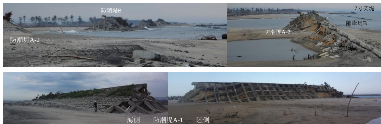
写真17-2 防潮堤の破堤：2011.7
