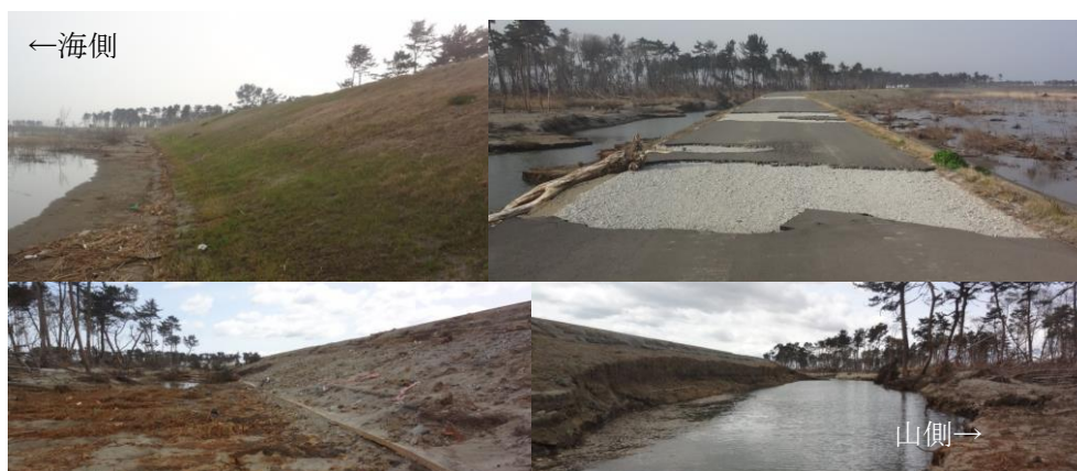
写真69 津波が越流した井土浦の河川堤防：上左・表法、上右・天端、下・裏法～裏法先、2011.5
