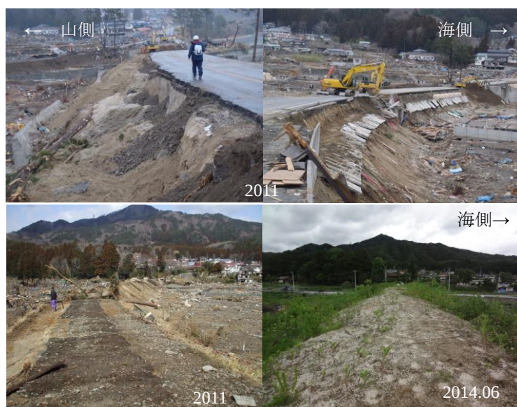
写真70 津波が越流した浪板地区の道路盛土、鉄道盛土：上・道路盛土、下・鉄道盛土、右 2014.6 *2011の津波直後の写真は、浪板地区代表：台野 宏氏及び東北地方整備局の提供による
