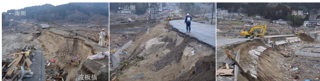
写真24-3 国道45号の盛土の被害状況：国土交通省の提供に加筆
