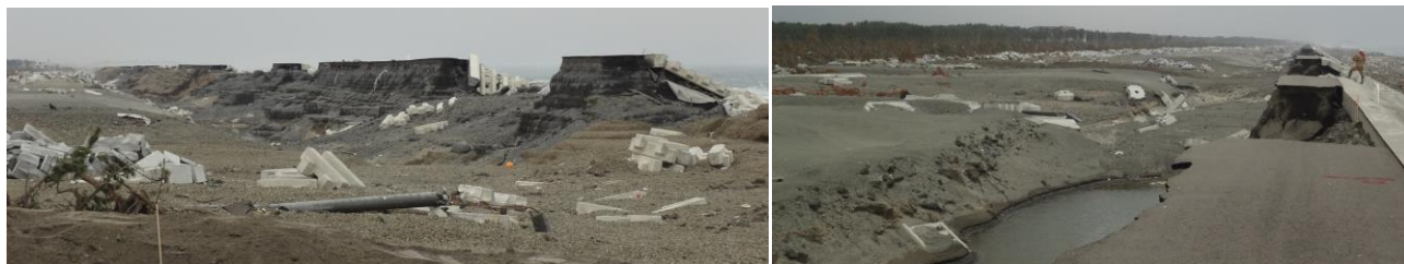
写真18-1 決壊した防潮堤：岩沼市寺島、2011.7
