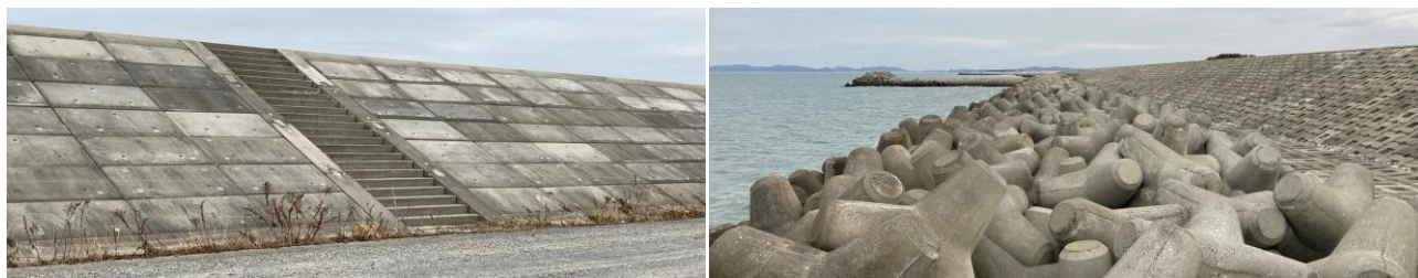
写真14-2 防潮堤の陸側と海側：東松島市大曲浜・東端付近
