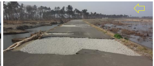
津波の越流に耐えた河川堤防：井土浦地区
