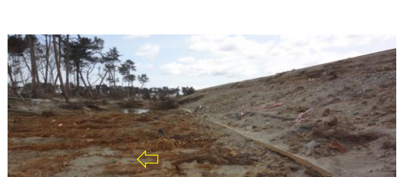
押し波でも表層侵食に留まった河川堤防：井土浦地区
