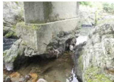
(2)橋脚周りの洗掘
