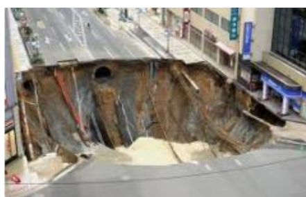
写真2 地下鉄工事中の道路陥没事故（福岡博多駅前） 2)
