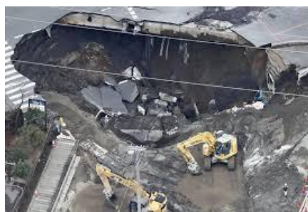
写真 4 八潮市における道路陥没事故 7)
