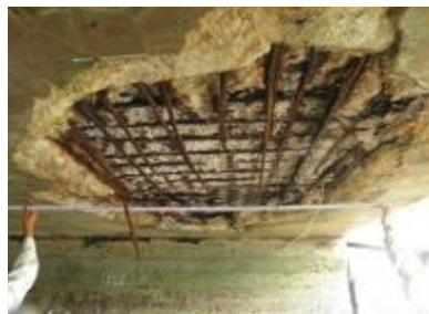
(1)床板鉄筋の露出
