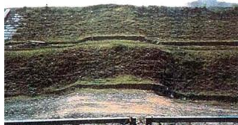
写真 3 樋門付近の盛土の抜け上がり 6)
