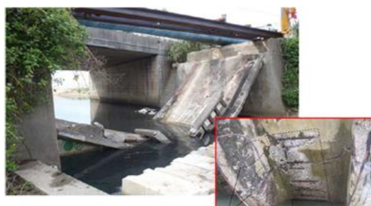
写真6 老朽化による落橋（沖縄） 12)
