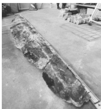
写真 13 落下していたコンクリート塊（山陽新幹線・北九州トンネル） 36)
