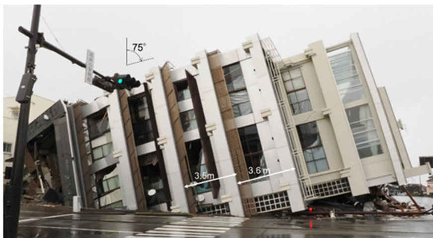
写真 6.2 転倒した建物（南側から撮影）
