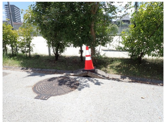
写真-3 100 m 程度離れた地点で認められた側溝の座屈
