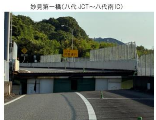
写真1 妙見第一橋の被害：文献6の抜粋 奥が断層の下盤、手前が上盤
