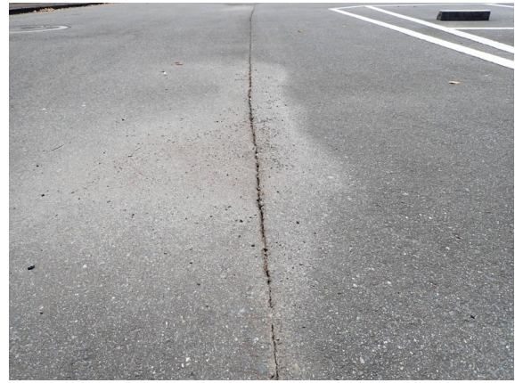
写真-2 500 m 程度離れた地点で認められた亀裂と噴砂
