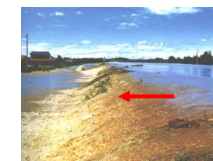
那珂川の越水: 出典)建設省常陸工事事務所資料
