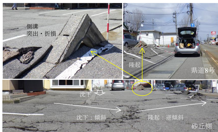
写真-6 駐車場などの隆起・沈下・傾斜：断面1付近
