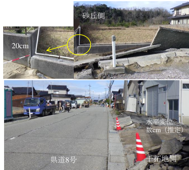
写真-3 県道8号と沿道の変状：西荒屋交差点付近：断面2
