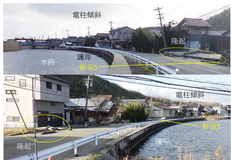
写真-12 護岸による地盤流動の抑制が推測される事例
