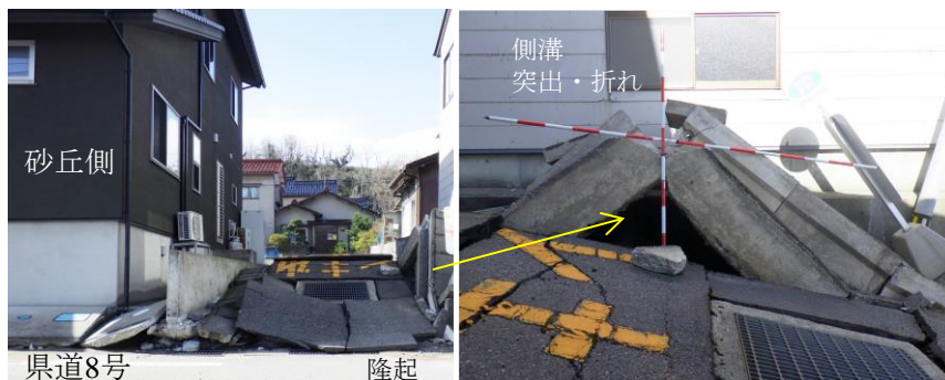
写真-8 交差道路の隆起：西荒屋地区、断面3
