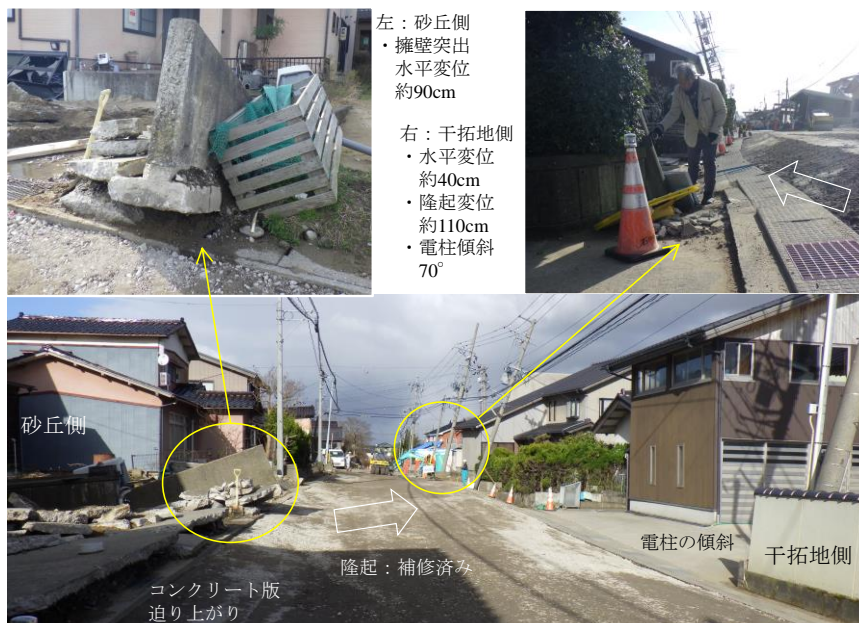
写真-4 道路の隆起による干拓地側への変状
