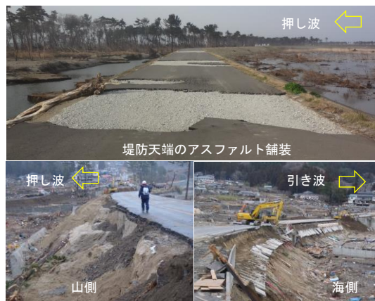
写真-21 天端の舗装の損傷は軽微：上・堤防，下・道路盛土
