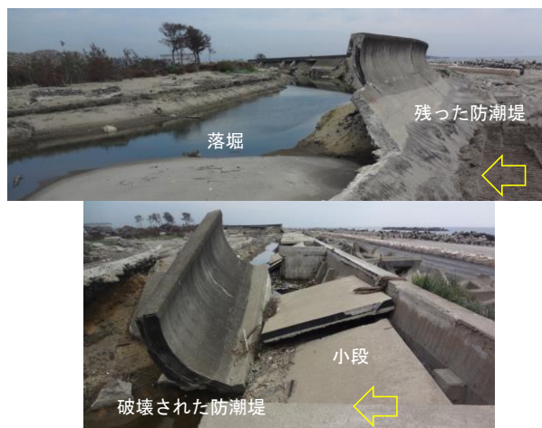
写真-16 同じ構造でも破壊の有無に差異がある防潮堤
