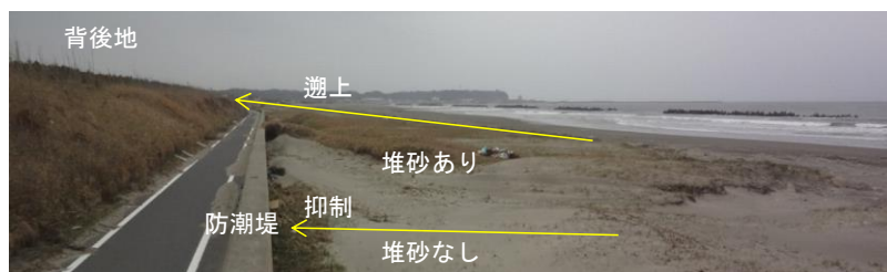
写真-17 防潮堤の前面が堆砂して耐津波性が変化
