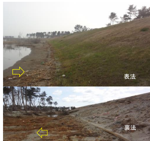
写真-11 堤防の侵食しない表法と侵食した裏法
