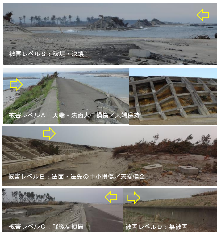
写真-23 被害の規模・形態に差異がある防潮堤
