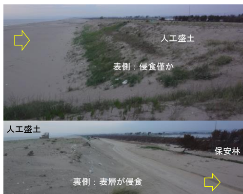
(1) 人工盛土の侵食状況と背後に残った保安林
