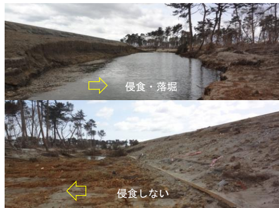
写真-13 裏法尻部が侵食された箇所と侵食されない箇所
